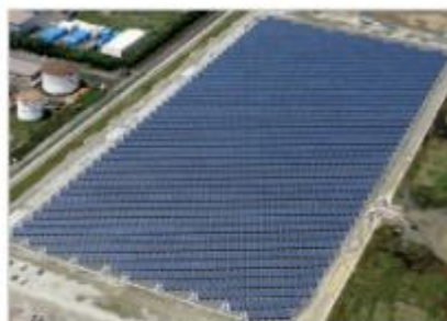
中国電力(株)様 福山太陽光発電所
