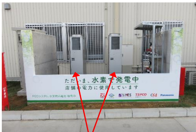
純水素燃料電池
