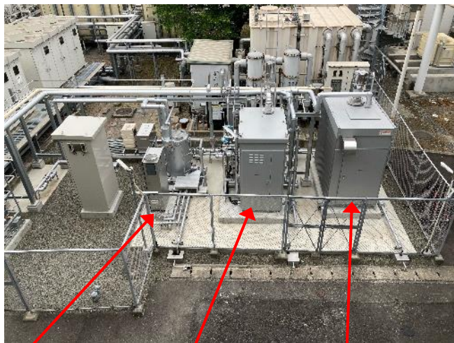
純水素燃料電池
